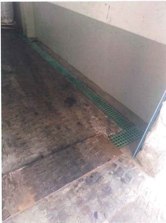
危废仓库防漏措施
